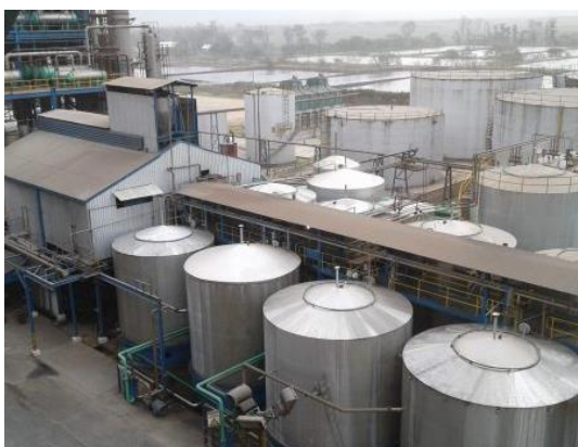
Imagen 40: Tanques de almacenaje y conversión a H 2 O
