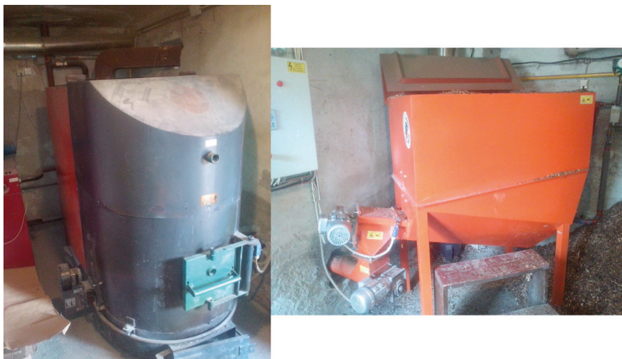
3. kép: Teljesen automatikus 80 KW-os kazán (napközi)
